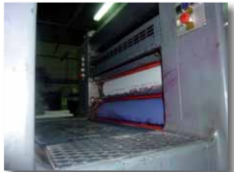
Barras de atrapamiento fijos. Fuente: DIN Impresores
