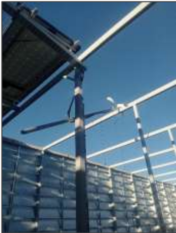
9 Estructura inestable en cubierta
