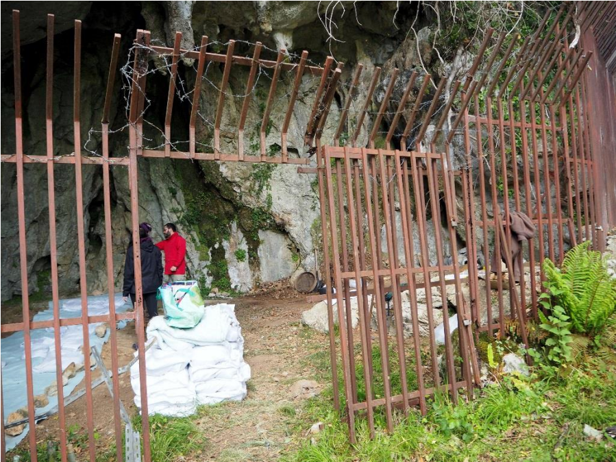
Figura 22. Estado de deterioro en el que se encuentra la reja de Cova Rosa en la zona de la puerta (foto JFJP).
